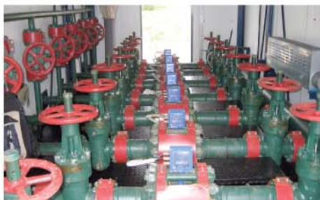
«Взлет ППД» установлены на блоке гребенок
